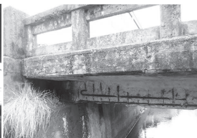
写真-2 鉄筋が錆びた橋桁
