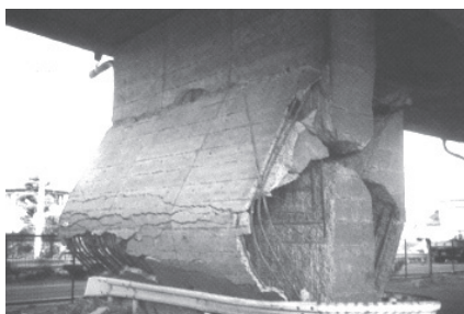
写真-1 被災（せん断破壊）した名神高速道路守部高架橋
